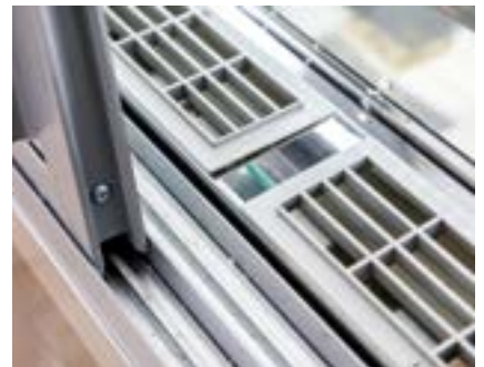
Laufschiene der Schiebetür und Luftführungsgitter
